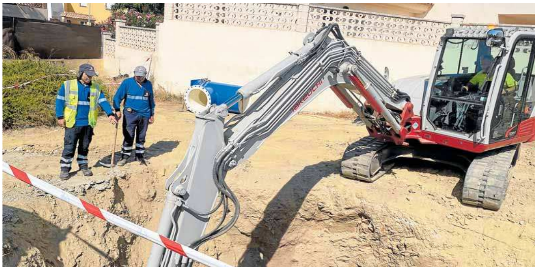
La actuación de emergencia de Acosol comenzó ayer y se espera que esté concluida el próximo viernes. J. C. GARCÍA
